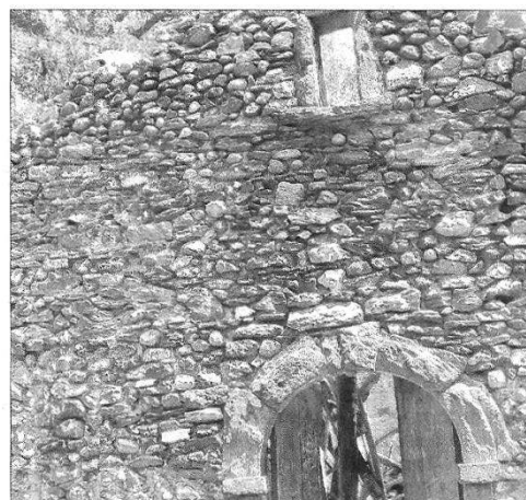
La chapelle Saint-Joseph est victime des intempéries et des vandales qui ont fini de détruire le lieu.
